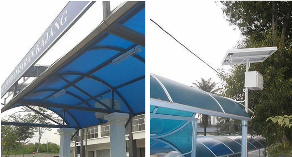
Foto 28: Penjanaan Solar bagi Pencahayaan di Hentian Bas
