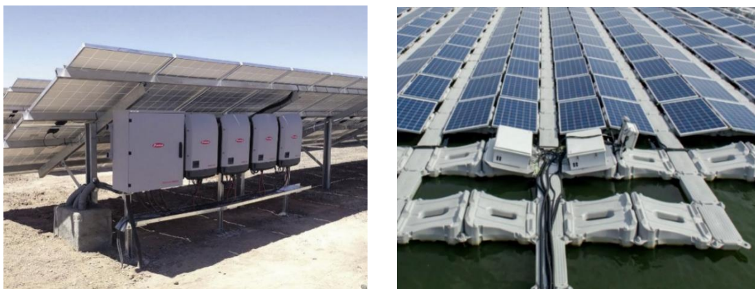
Foto 8: String Inverters Ladang Solar Atas Tanah dan Atas Permukaan Air
