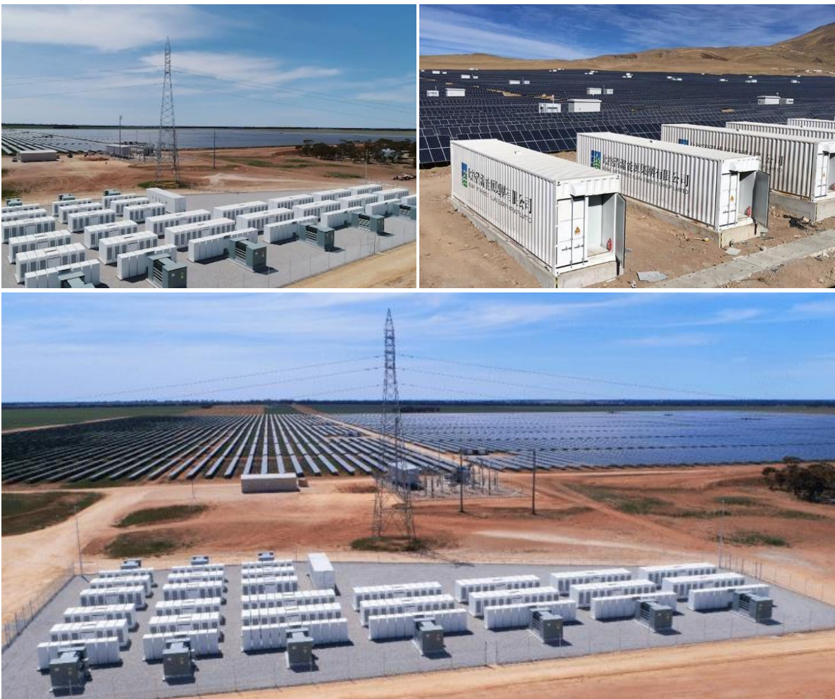
Foto 9: Pembangunan Ladang Solar Menggunakan Sistem Pengumpulan Tenaga Melalui Sistem Bateri Skala Grid di Victoria, Australia (kiri) dan di Yangyi, Tibet, China (kanan)
