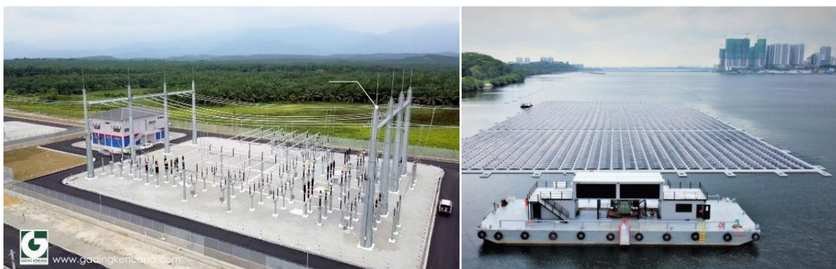
Foto 10: Pencawang Ladang Solar Atas Tanah di LSS Bidor (30 MW), Perak (kiri) dan Atas Permukaan Air di Singapura (kanan)
